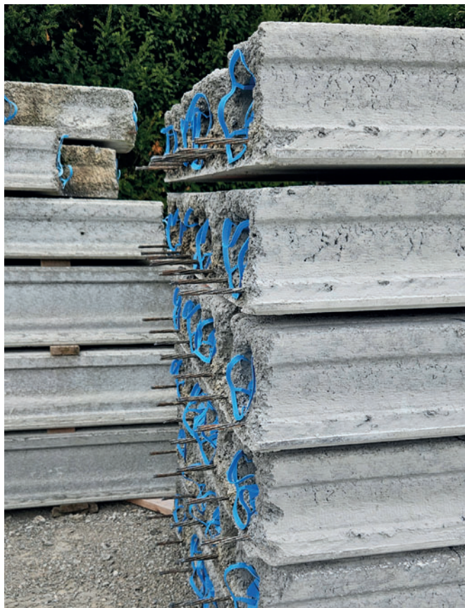
Пустотные плиты с обнаженной арматурой
